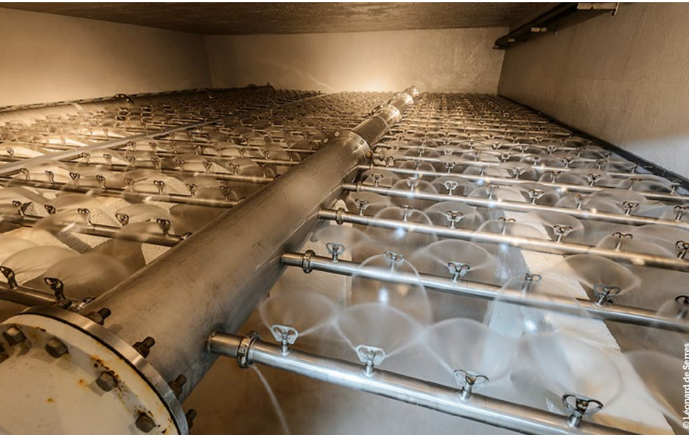
Étape de traitement (oxydation à l'air) de l'eau potable dans l'usine Quai de Portillon à Saint-Cyr-sur-Loire.
