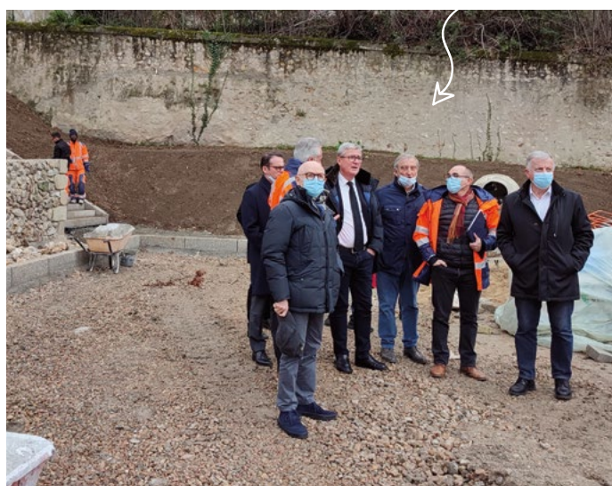
Le 13 décembre 2021, Philippe Briand, accompagné d'élus et d'agents municipaux, a fait un point d'avancement sur les travaux du futur parking du « coteau de la mairie ».
